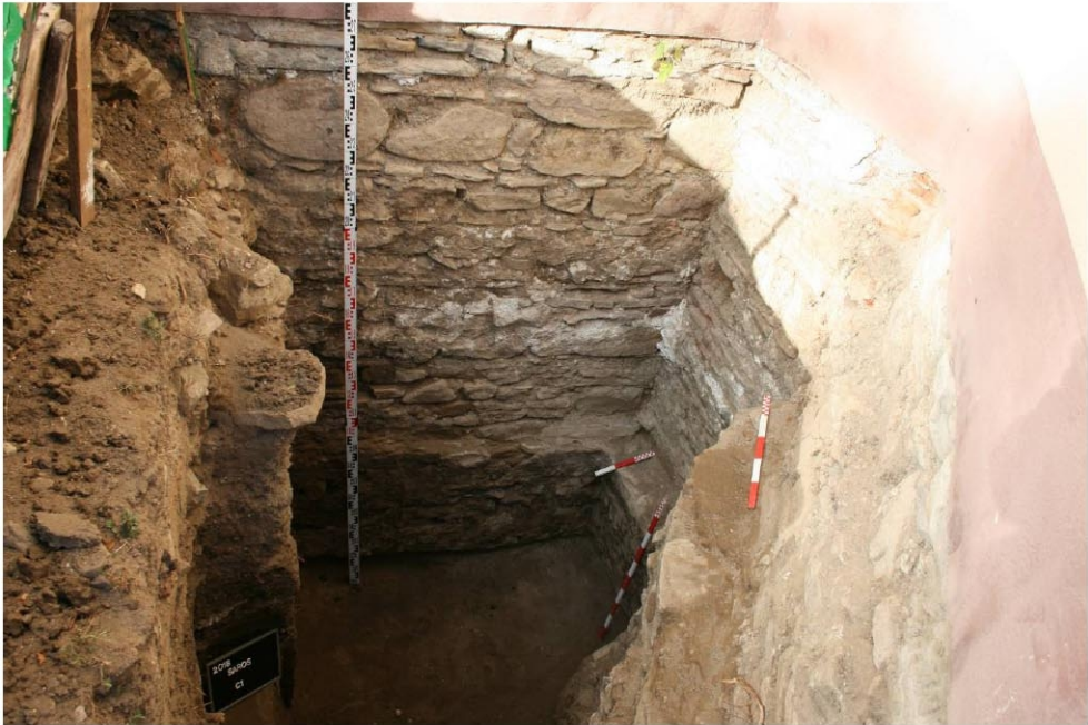
Fig. 4b. C1 – detaliu fundație a laturii de sud a turnului și a laturii de vest a navei
