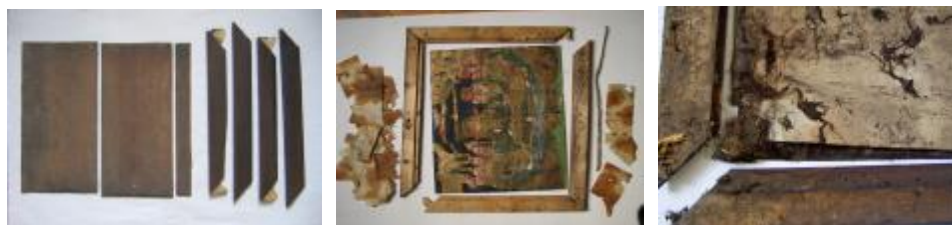
Degradări specifice elementelor din lemn
